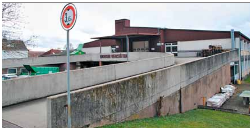
Die vormaligen Werkstätten aus Stahlbeton konnten die veränderten Anforderungen an eine zeitgemäße Begleitung nicht mehr erfüllen. Foto: Waechter + Waechter Architekten
