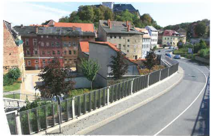
Bild 1. In der Georgenkirchstraße in Weißenfels/Sachsen-Anhalt kam das fast „unsichtbare“ Lärmschutzsystem CLEARWALL® von Kohlhauer zum Einsatz
